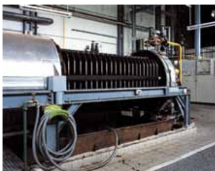
Filtr płytowy gotowy do sprawdzenia i oczyszczenia
