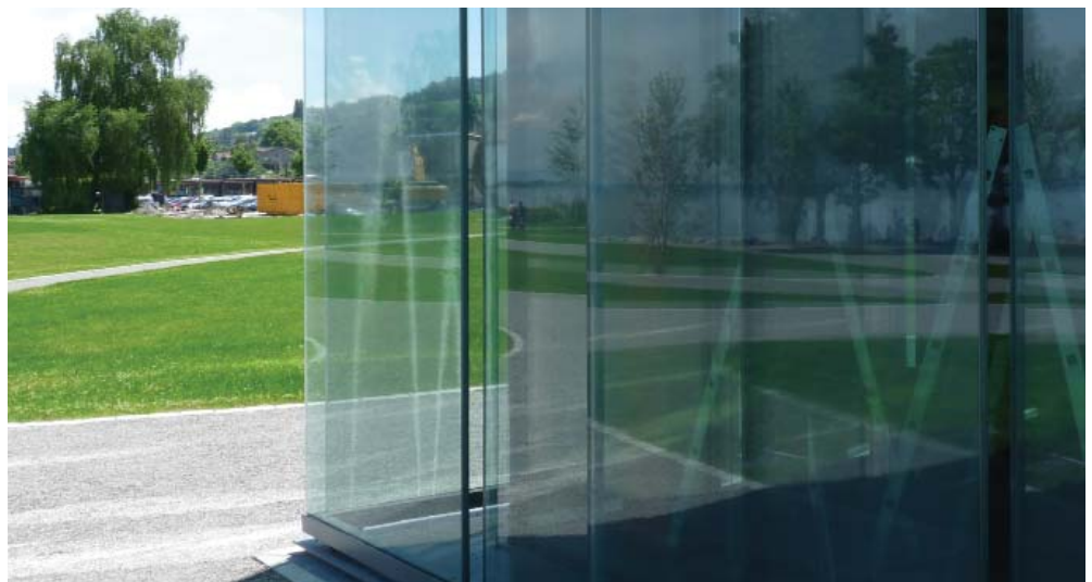
Abb. 16. Durch die doppelte Wirkung des Gewebes werden die Eckbereiche schummrig und verlieren dadurch erheblich an Gefahrenpotenzial. An transparenten Gebäudeecken sehen Vögel durch, weshalb sie oft versuchen, diagonal durchzufliiegen.
